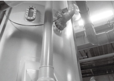
▲ 工業用水を事業用に浄水する設備
