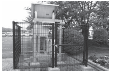
計測を継続する可搬型モニタリングポスト
