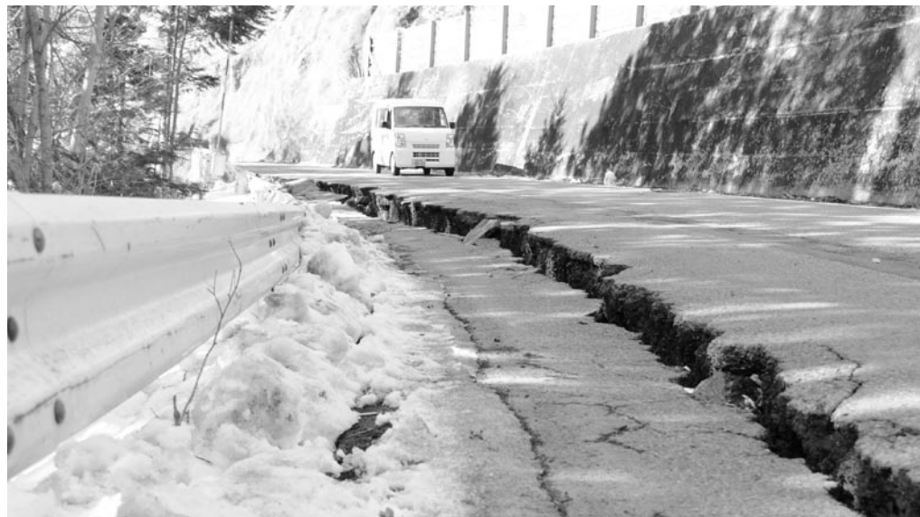
▲白河～羽鳥線 真名子付近 地割れした道路
