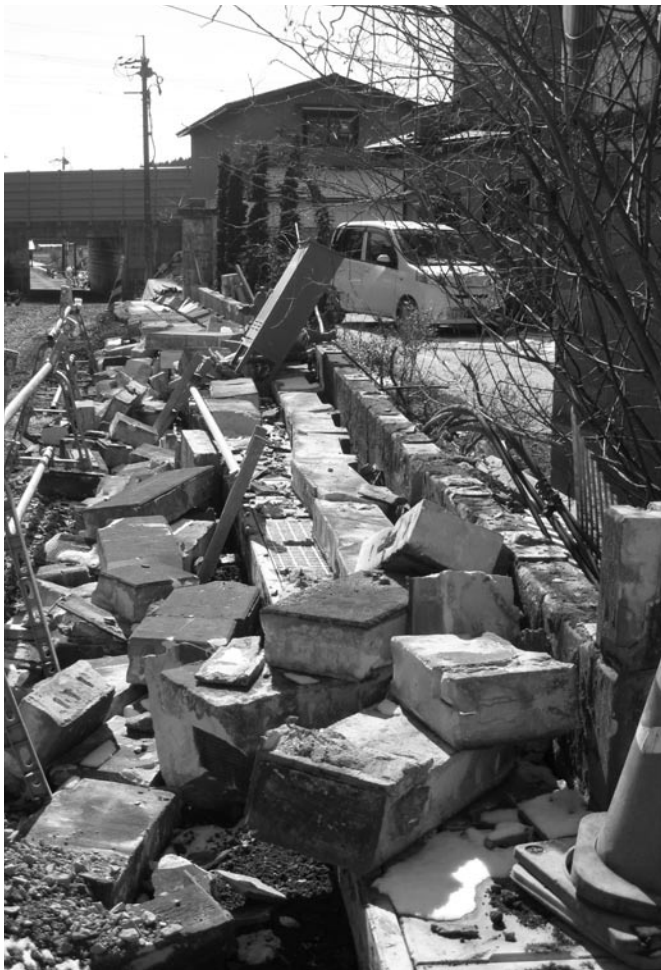
▲大清水付近 崩れた塀
