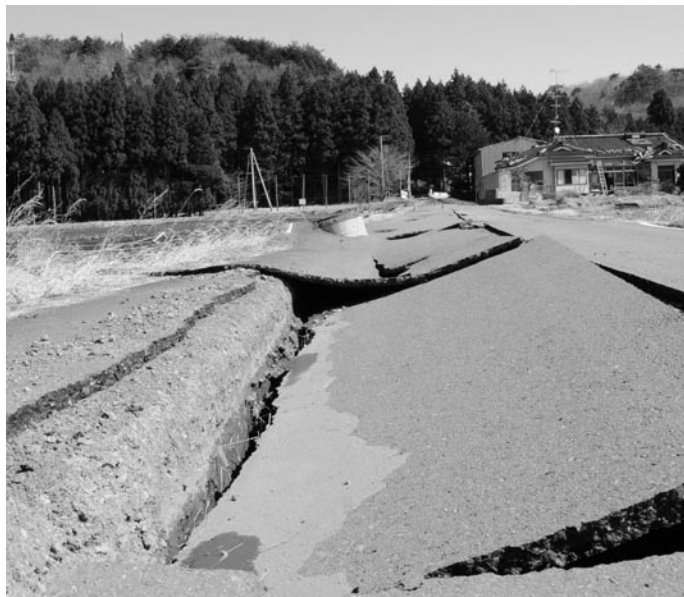
▲羽太地区 道路の陥没
