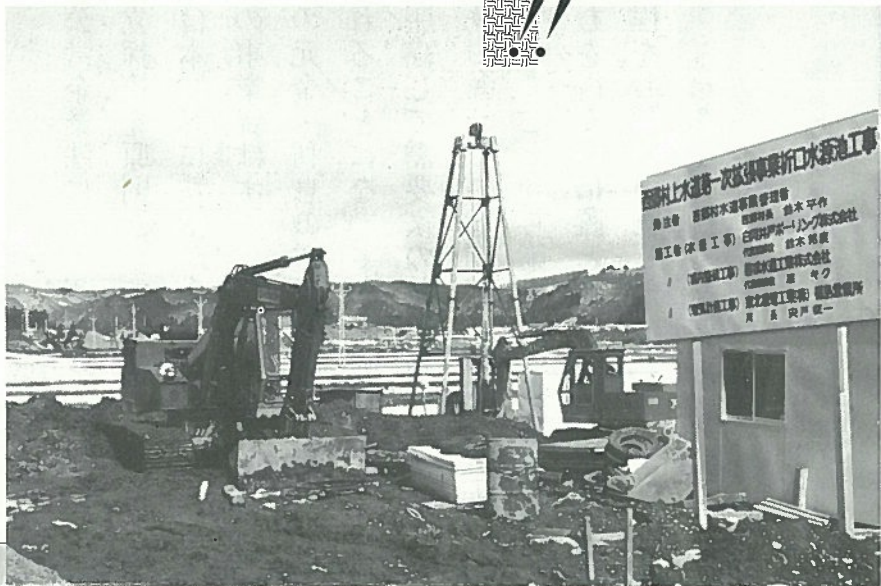
▲水原池さく井工事～復合井理輪により（深井戸深さ80m 径50cm 4ヶ所揚水量1日当5400トン）井戸掘削工事
