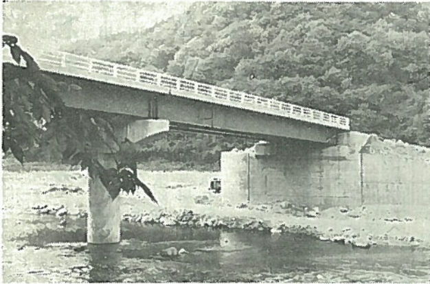
◀防衛施設周辺民生安定事業 追原羽鳥線外 道路改良工事 (逢隈橋架換工事) 事業費 29,000千円 L=47.46m W=7.0m
