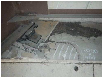
021. 鶴の子橋：鋼I桁橋 (橋長：29.00m、1990年竣工) 橋台橋座面（沓座近辺）のうき ※地震等の外力により、損傷は進行する可能性が高い。（迂回路有り）
