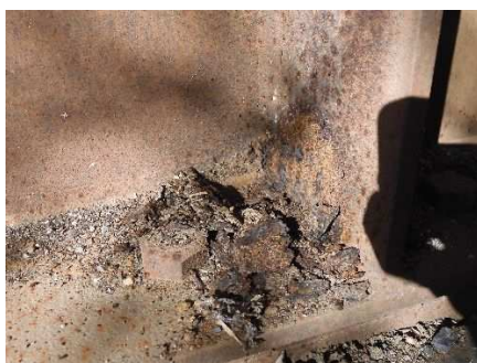
016. 一の又橋：鋼I桁橋 (橋長：34.20m、1985年竣工) 主桁端部の板厚減少を伴う腐食 ※主桁端部の板厚減少により、耐荷力の低 下が推測される。(迂回路有り)
