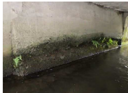
095. 5009：RC床版橋+ボックスカルバート (橋長：2.70m、1987年竣工) 橋台前面の断面欠損 ※著しい断面欠損により、鉛直支持機能の低下が推測される。（迂回路有り）
