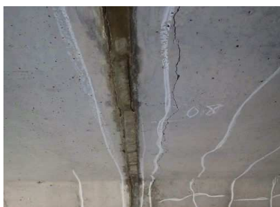
050. 4021：ボックスカルバート橋 (橋長：2.90m、1987年竣工) 頂版及びハンチ部のひびわれ ※雨水の浸入により、進行する可能性が高い。（迂回路有り）
