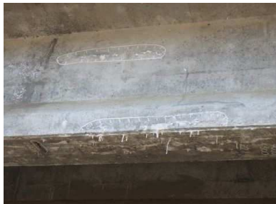
023. 幸せ橋：ポステンT桁橋 (橋長：28.60m、1974年竣工) ポステン桁下面の遊離石灰を伴うひびわれ ※雨水の浸入により、内部鋼材の腐食が進 行する可能性が高い。(迂回路有り)
