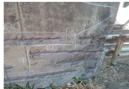
013. 大清水橋：PCラーメン橋 (橋長：41.20m、1973年竣工) 橋脚(垂直材)の剥離・鉄筋露出 ※広範囲な鉄筋露出により、鉛直支持機能 の低下が推測される。 (迂回路有り)
