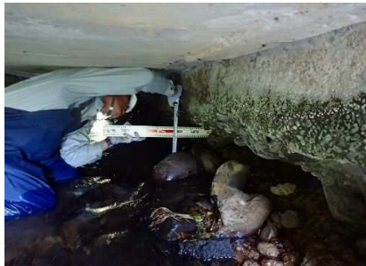
115. 4024：RC床版橋 (橋長：2.00m、1987年竣工) 橋台基礎部の洗堀 ※基礎部の洗堀により、鉛直支持機能の低下が推測される。（迂回路有り）
