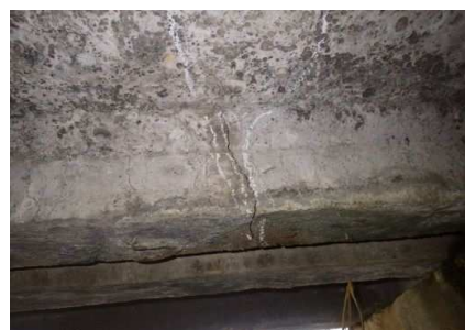
091. 1008：RCπ桁橋 (橋長：3.00m、1987年竣工) 主桁下面の橋軸直角方向ひびわれ ※車両の通行により、損傷は進行する可能性が高い。（迂回路有り）
