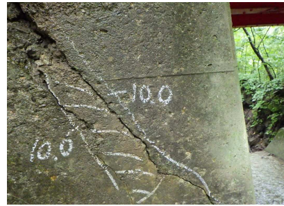
047. 剣桂橋：RCT桁橋 (橋長：8.10m、1935年竣工) 橋台側面の斜め方向ひびわれ ※地震等の外力により、橋台の欠損に進展する可能性が高い。（迂回路有り）
