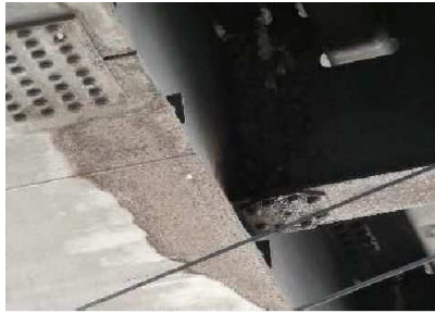
002. 西郷高原大橋： 鋼箱桁橋＋プレテンT桁橋 (橋長：255.00m、1995年竣工) 鋼主桁の板厚減少を伴う腐食 ※主桁の板厚減少により、耐荷力の低下が 推測される。(迂回路有り)
