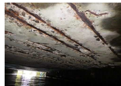
080. 0202-1：RC床版橋 (橋長：3.90m、1987年竣工) 床版下面の鉄筋露出・うき ※露出鉄筋の著しい腐食により、耐荷力の 低下が推測される。(迂回路有り)
