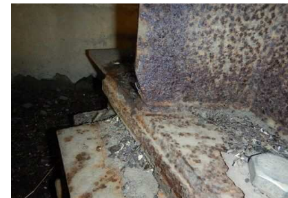
014. 中島橋：鋼I桁橋 (橋長：40.70m、1984年竣工) 主桁端部の板厚減少を伴う腐食 ※主桁端部の板厚減少により、耐荷力の低 下が推測される。(迂回路有り)
